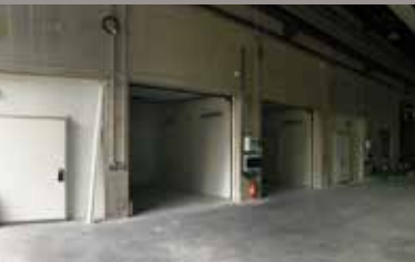
4 enceintes climatiques à ambiances contrôlées (température et humidité)
